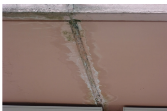
Infiltration et corrosion à l'origine de la plupart des sinistres.
