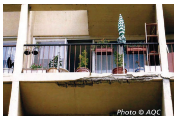
L'éclatement des nez de balcons fragilise la pérennité de la structure.
