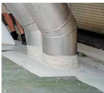
Toits plats – Tuyaux de ventilation
