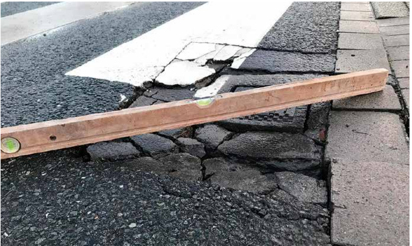
Abgesackte Schieberkappe in der Fahrbahn
