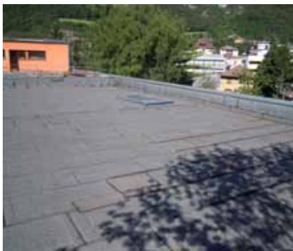
Prima del risanamento con Triflex: nel tempo, la membrana bituminosa sul tetto piano della scuola elementare di Bressanone era diventata porosa.
