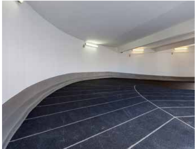
Die steil geneigte Kurve der Einfahrtsrampe ist hohen Schub- und Scherkräften ausgesetzt.
